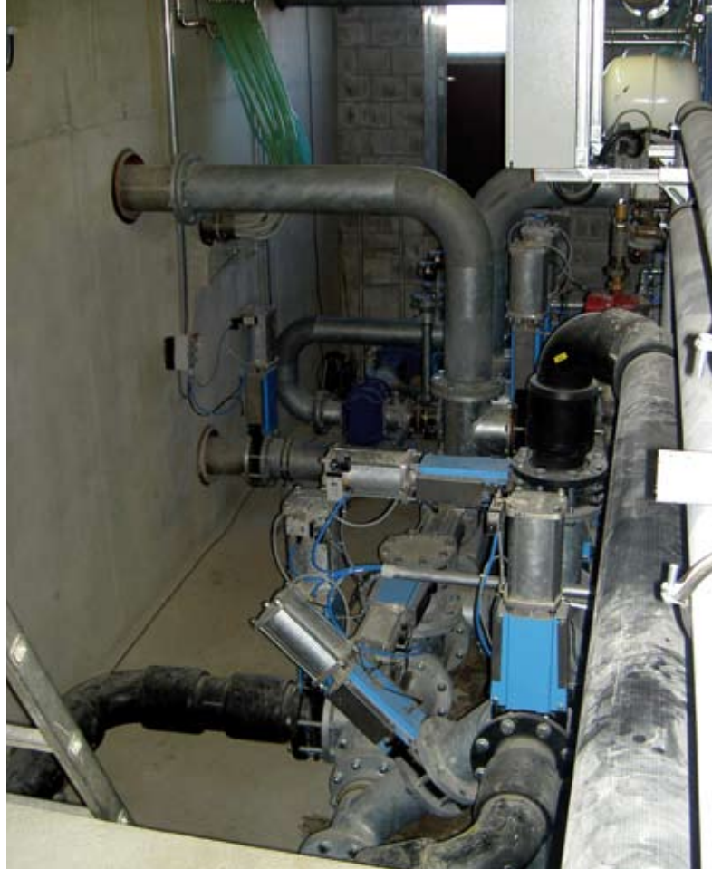
Unterirdischer Durchgang mit Leitungen
