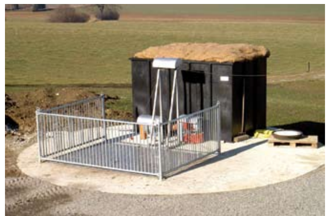
Biofilter über der Vorgrube
