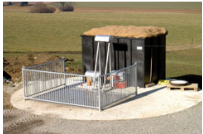
Biofiltre surmontant la préfosse
