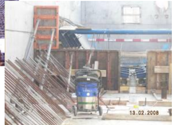
L'arrondi du fond du digesteur
