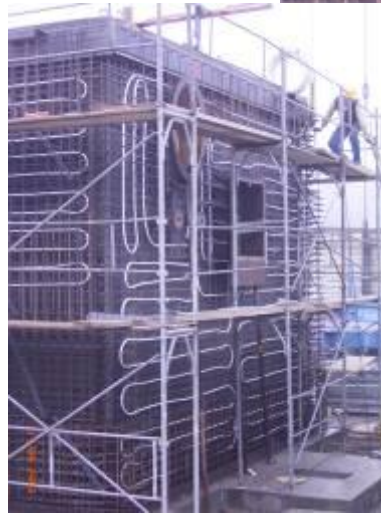
Les murs du digesteur avec le chauffage
